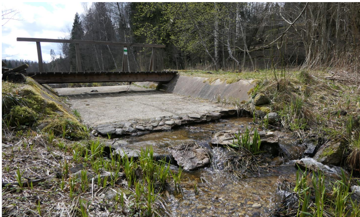
Foto 2. Vaade ülevoolule alavee poolelt (30.04.2020). Vesi väljub betoonplaadi alt.
