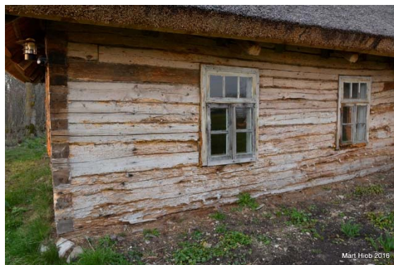
Foto 269. Tugevalt kahjustunud uu rookatusega Veedrese elamu sein. Foto Mart Hiob 2016.
